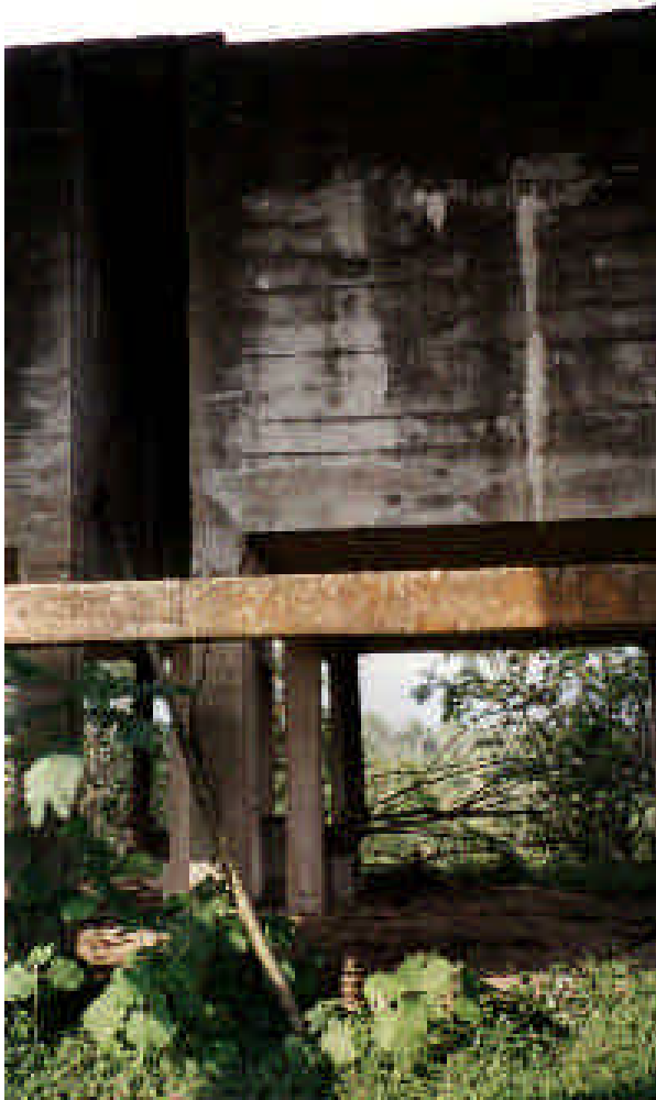
Fotografía 12. Tanto los filtros, como el depósito distribuidor, se encuentran seriamente dañados por la falta de mantenimiento.
