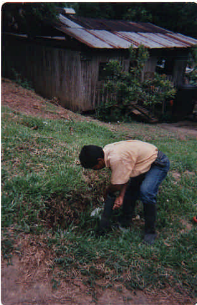
Fotografía 16. Un operario de la Alcaldía se encarga de accionar manualmente, el complejo sistema de válvulas.
