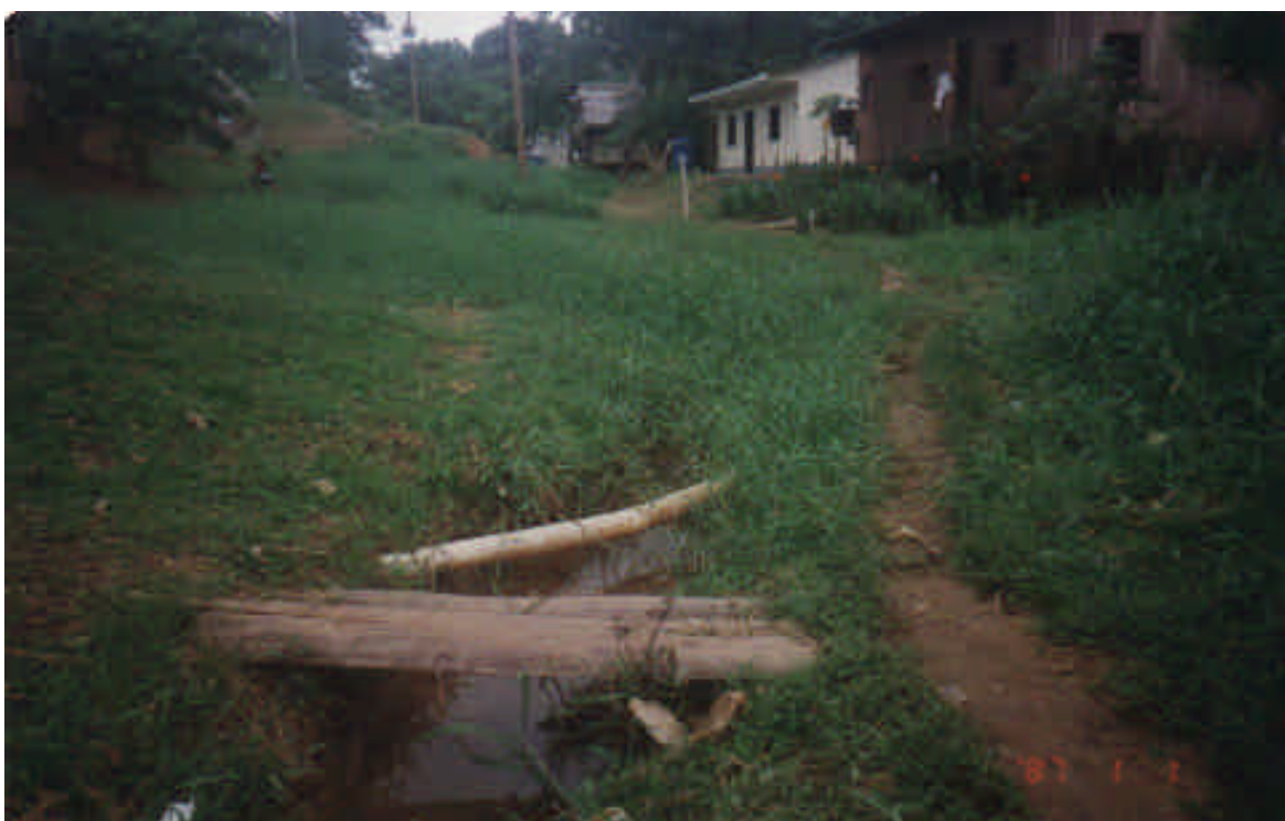
Fotografía 34. Alcantarillado en mal estado.
