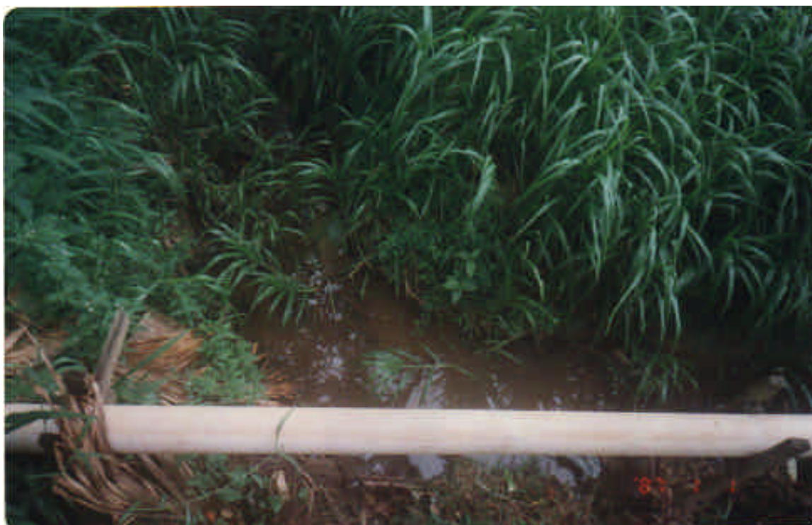
Fotografía 25. No obstante, el alcantarillado existente no se encuentra en buenas condiciones, y muchas veces está desprotegido frente a agentes externos.
