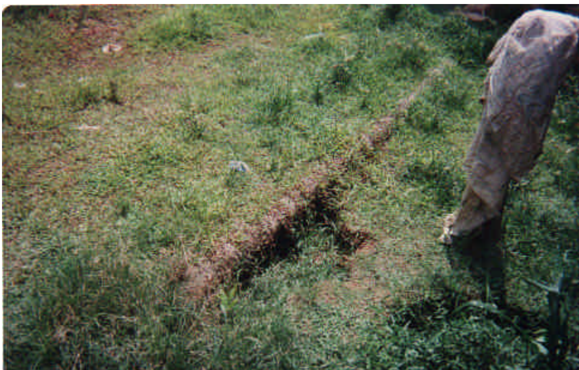
Fotografía 40. Existe todavía, una tubería de hormigón, seriamente dañada y que provoca graves problemas a las familias conectadas.
