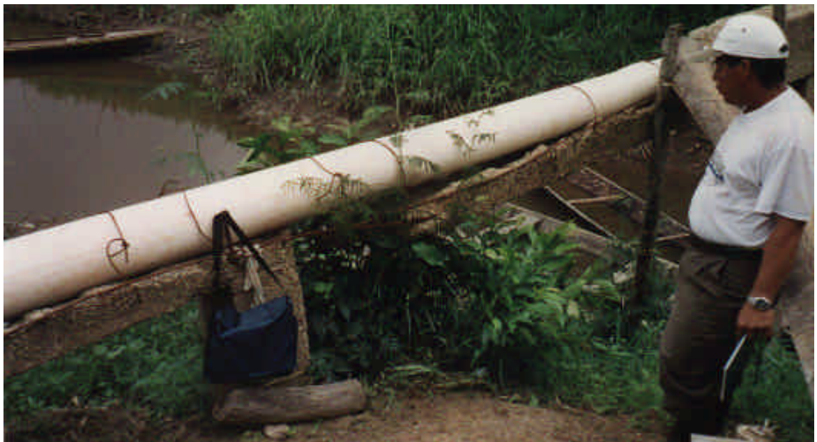
Fotografía 26. Existen algunos puntos, donde el alcantarillado se ha intentado proteger adecuadamente.
